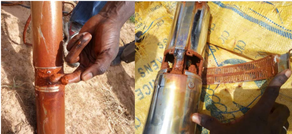
Figure 9 Dépôts de boue sur les éléments de la pompe
